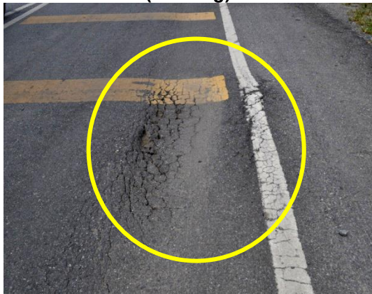
Gambar 1.10 Kerosakan Jalan Jenis Penyodokan ( Shoving )
