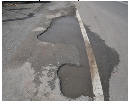
Gambar 1.31 Keadaan Tepi Jalan Tempat Air Bertakung
