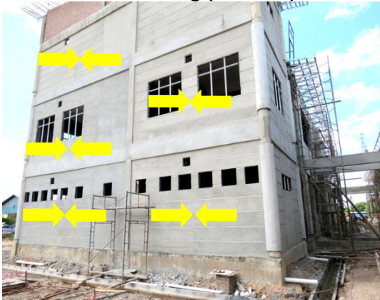
Gambar 2.4 Dinding Bata Melebihi 6 Meter Lebar Tidak Dibina Tiang (Stiffener)
