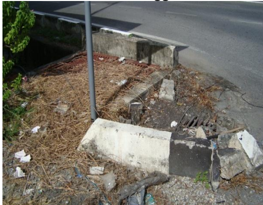
Gambar 1.28 Keadaan Longkang Dan Kerb Yang Rosak Tidak Disenggara
