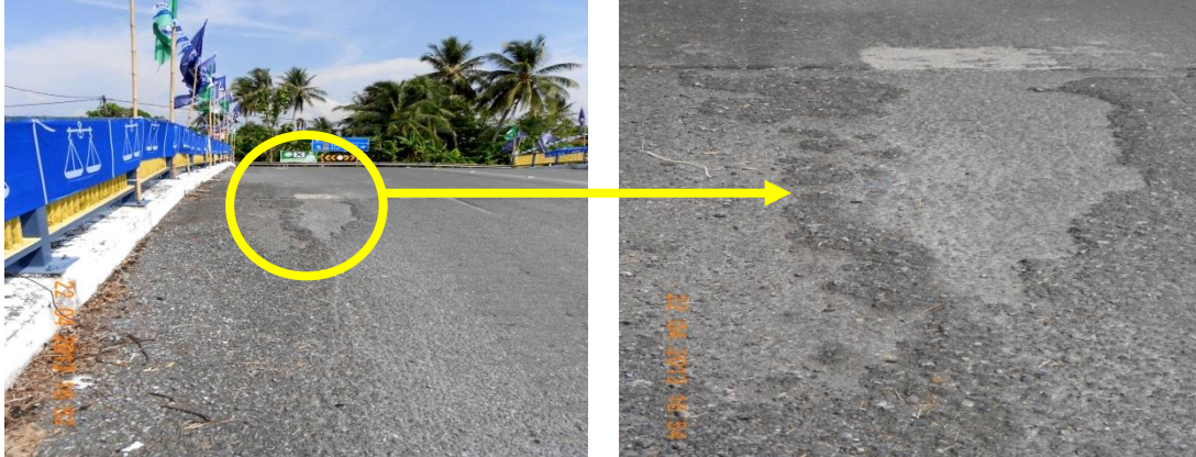
Gambar 1.14 Kerosakan Jalan Jenis Pengikisan ( Ravelling/Fretting )
