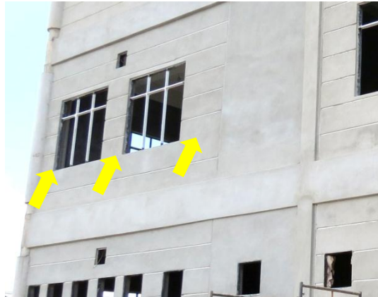
Gambar 2.5 Dinding Bata Bahagian Luar Tidak Dibina Aluminium Groove Line
