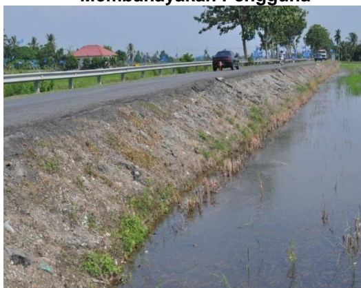
Gambar 1.4 Keadaan Jalan Jejawi - Tambun Tulang Yang Tidak Mempunyai Guardrail Dan Membahayakan Pengguna
