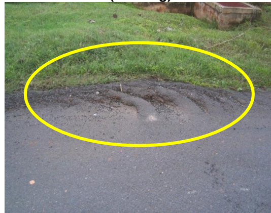
Gambar 1.11 Kerosakan Jalan Jenis Penyodokan ( Shoving )
