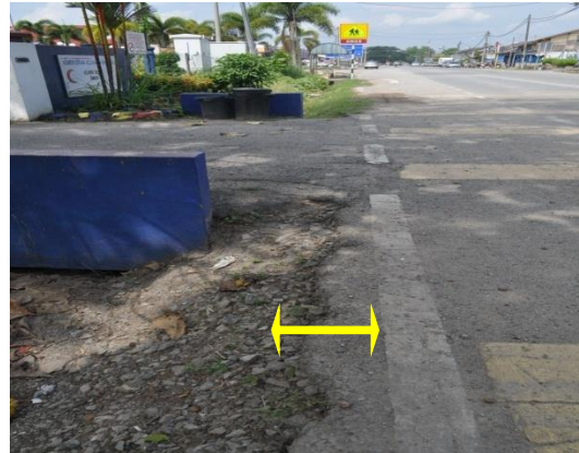
Gambar 1.29 Keadaan Bahu Jalan Yang Sempit dan Rosak
