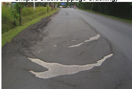
Gambar 1.34 Keadaan Jalan Yang Mengalami Keretakan Jenis Gelinciran ( Crescent Shaped Crack/Slippage Cracking )
