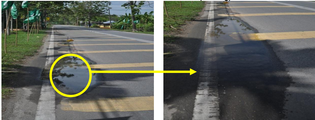
Gambar 1.9 Kerosakan Jalan Jenis Aluran ( Rutting )
