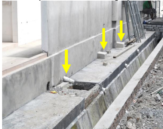
Gambar 2.3 Saluran Pipe Pembuangan Lebih Tinggi Daripada Level Finishing Apron
