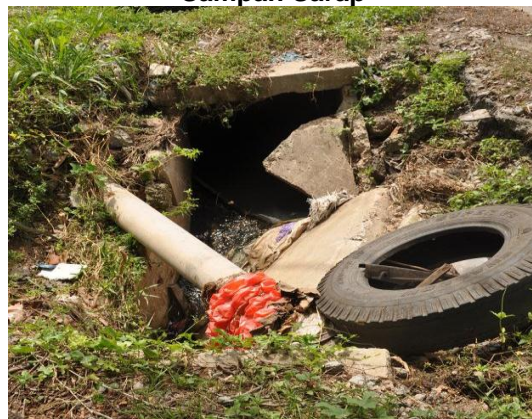
Gambar 1.25 Keadaan Penutup Longkang Konkrit Pecah Dan Longkang Tersumbat Dengan Sampah Sarap
