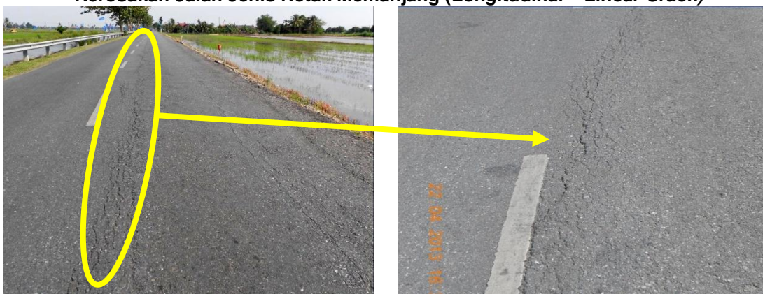
Gambar 1.6 Kerosakan Jalan Jenis Retak Memanjang ( Longitudinal – Linear Crack )
