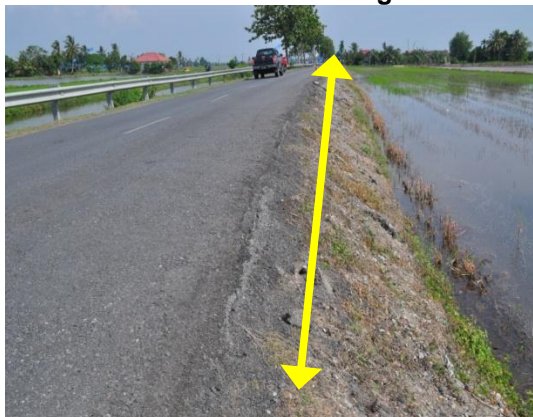
Gambar 1.30 Keadaan Bahu Jalan Yang Curam
