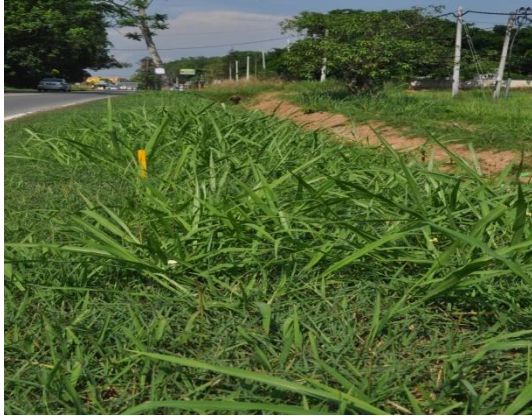
Gambar 1.26 Keadaan Bahu Jalan Yang Di Tumbuhi Rumput Panjang
