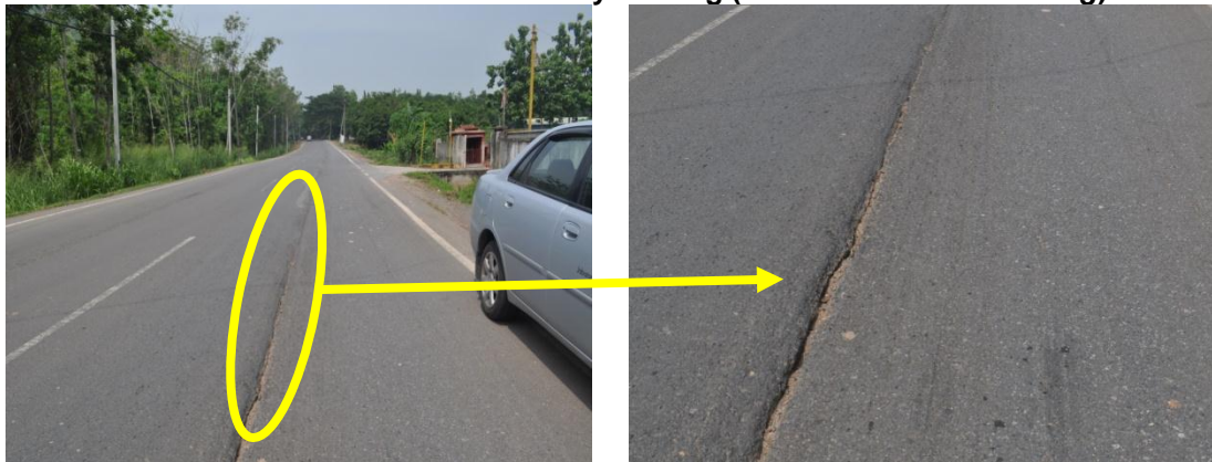
Gambar 1.8 Kerosakan Jalan Jenis Retak Penyambung (Joint Reflection Cracking)
