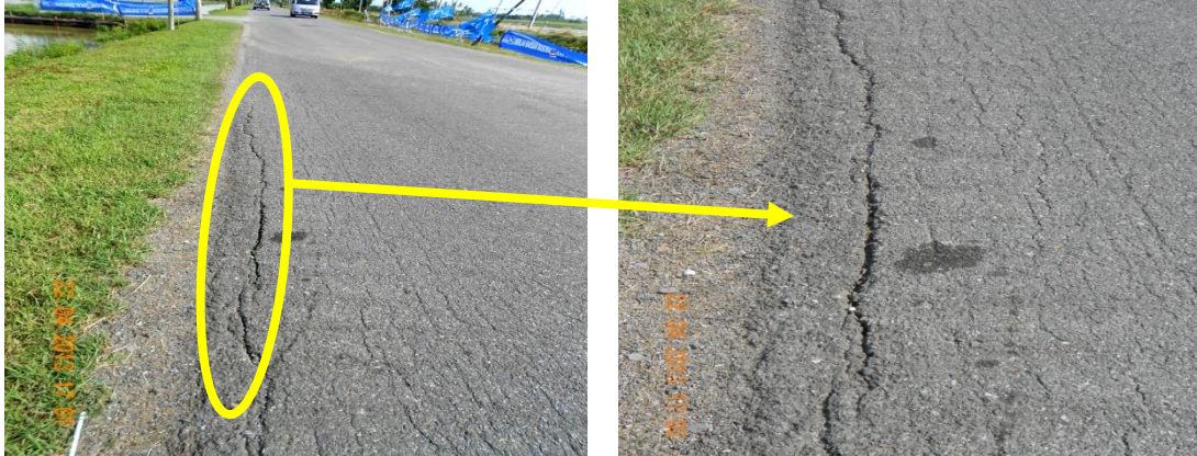
Gambar 1.7 Kerosakan Jalan Jenis Retak Tepi (Edge Crack)
