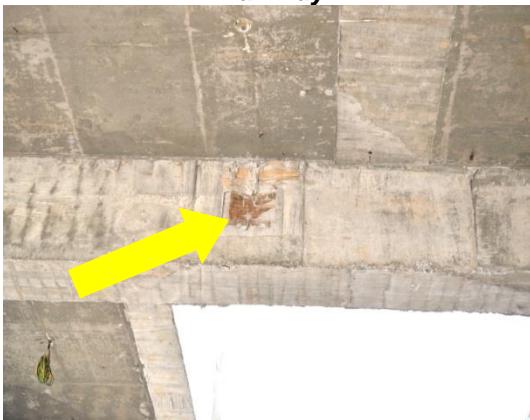
Gambar 2.10 Terdapat Sisa Formwork Pada Siling Walkway
